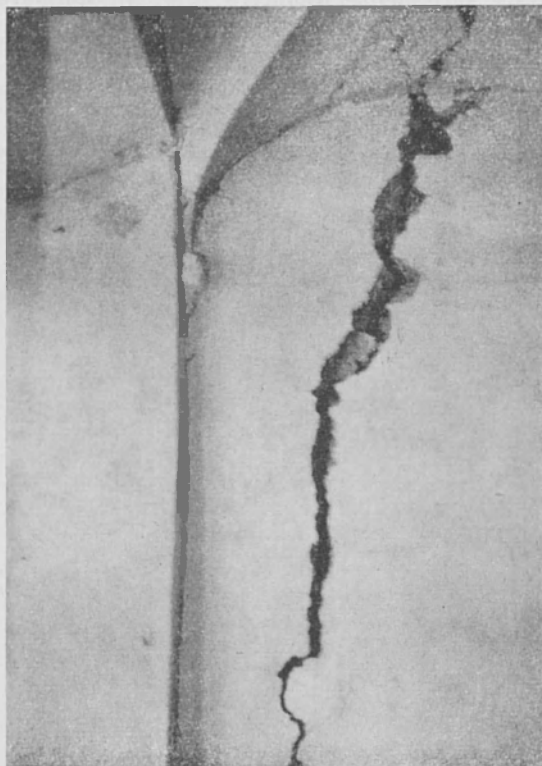
Fig. 6 - Castello di Rota. Grave lesione nella parete della scala che conduce dal 1° al 2° piano. (Foto G. Cirilli)
