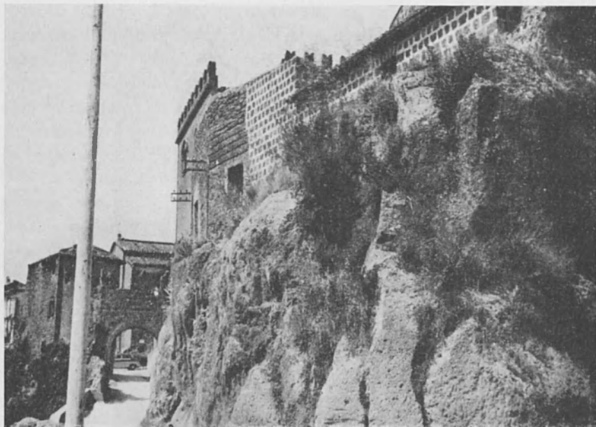
Fig. 7 - Il Castello di Civitella Cesi, poggiato, come tutte le case del paesino, su tufo vulcanico, ha subito sensibili lesioni in alcuni muri portanti e divisori. (Foto G. Cirilli)
