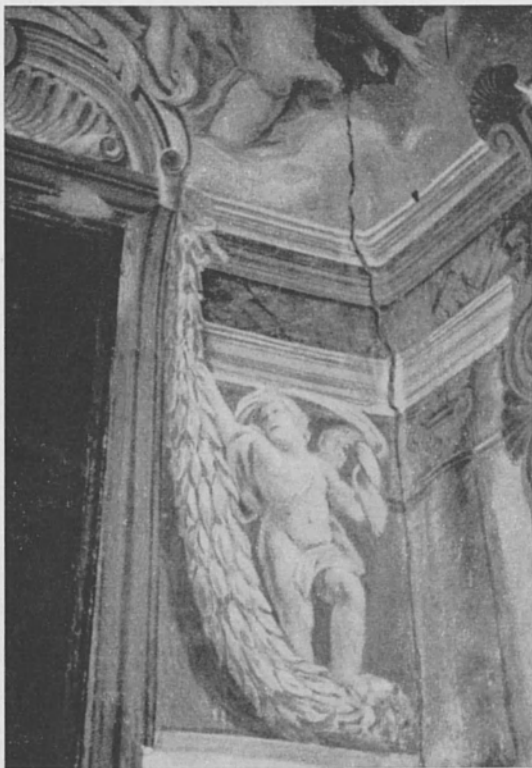
Fig. 5 - Castello di Rota. Lesioni nella volta e nelle murature laterali di una sala del primo piano.
